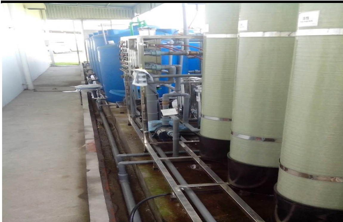
Hình 1-2: Hệ thống xử lý nước thải sinh hoạt tập trung Công ty TNHH Valqua Việt Nam
